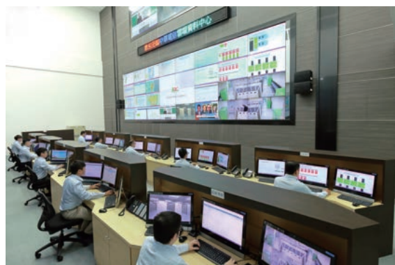
▲ NOC 網管中心 7X24 機房監控
